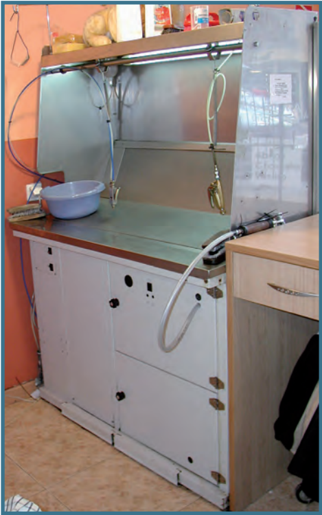
FOTO 6: CABINA DE DESMANCHADO DOTADA DE EXTRACCIÓN LOCALIZADA.
